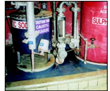
AREAS DE CONTENCIÓN DE QUÍMICOS
