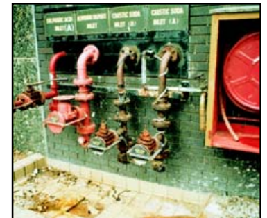
TRANSFERENCIA DE QUÍMICOS Y COMBUSTIBLES
