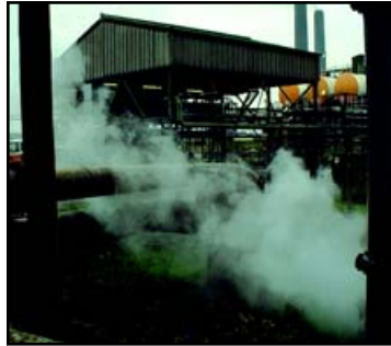
TUBERIAS DE VAPOR
