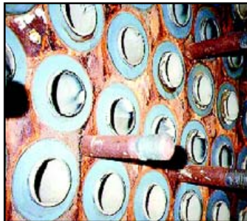
INTERCAMBIADORES DE CALOR
