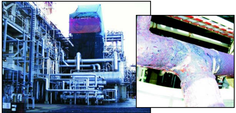
AISLAMIENTO TÉRMICO APARENTEMENTE EN BUEN ESTADO ...PERO POR DEBAJO, LA REALIDAD
