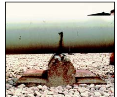
SOPORTES DE TUBERIAS
