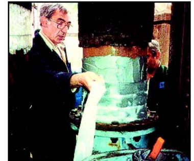
REPARAR TUBERIAS CORROIDAS
