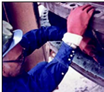
REFORMAR BRIDAS DISTORSIONADAS
